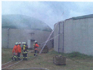
Der Angriffstrupp des HLF 10/6 der FF Schafflund hatte den Einsatzauftrag, den Brand im Bereich der Isolierung abzulöschen.
